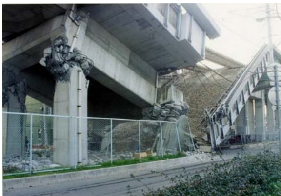
高架橋脚（柱）のヒンジ部の破壊
